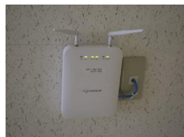
館内にあるWi-Fi 機器設備
